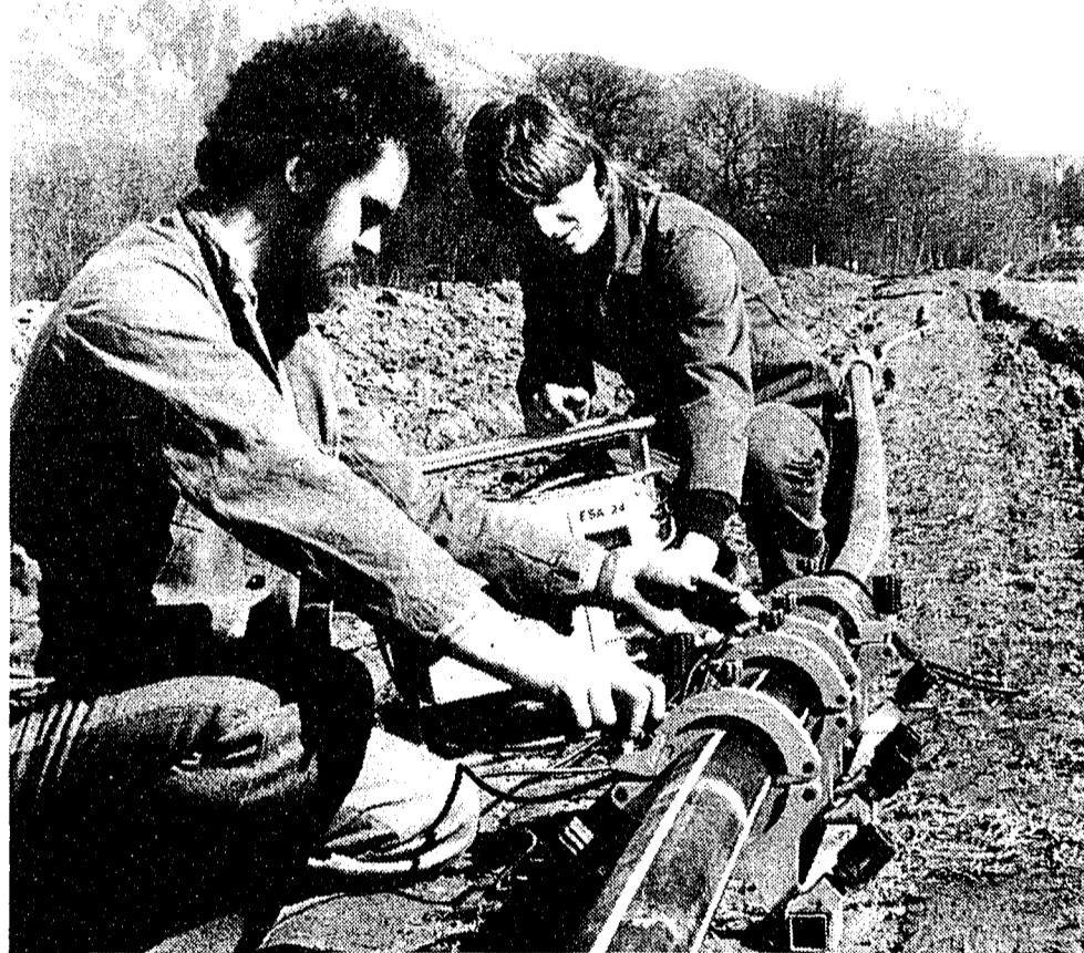
Der Anteil des Erdgases an der erfassten Gesamtenergiemenge machte 1987 bereits einen Umfang von 8,4 Prozent aus. Unser Archivbild zeigt die Verlegung von Erdgasleitungen.
