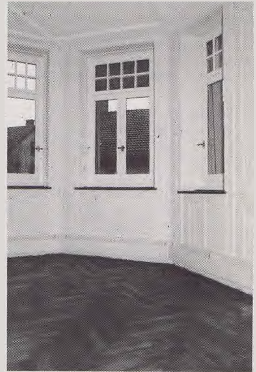
Fussleisten-Heizung, Holz (Bild: Lenz)
