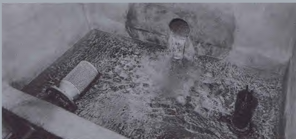
Brunnenstube der neuen Quelle oberhalb des Reservoirs Schaanwald
