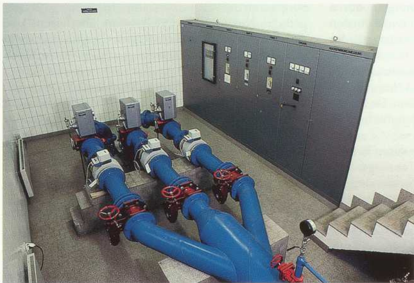
Das von 1971 bis 1973 erbaute Gemeinschaftspumpwerk der Gemeinden Schaan und Vaduz auf den Schaaner Wiesen
