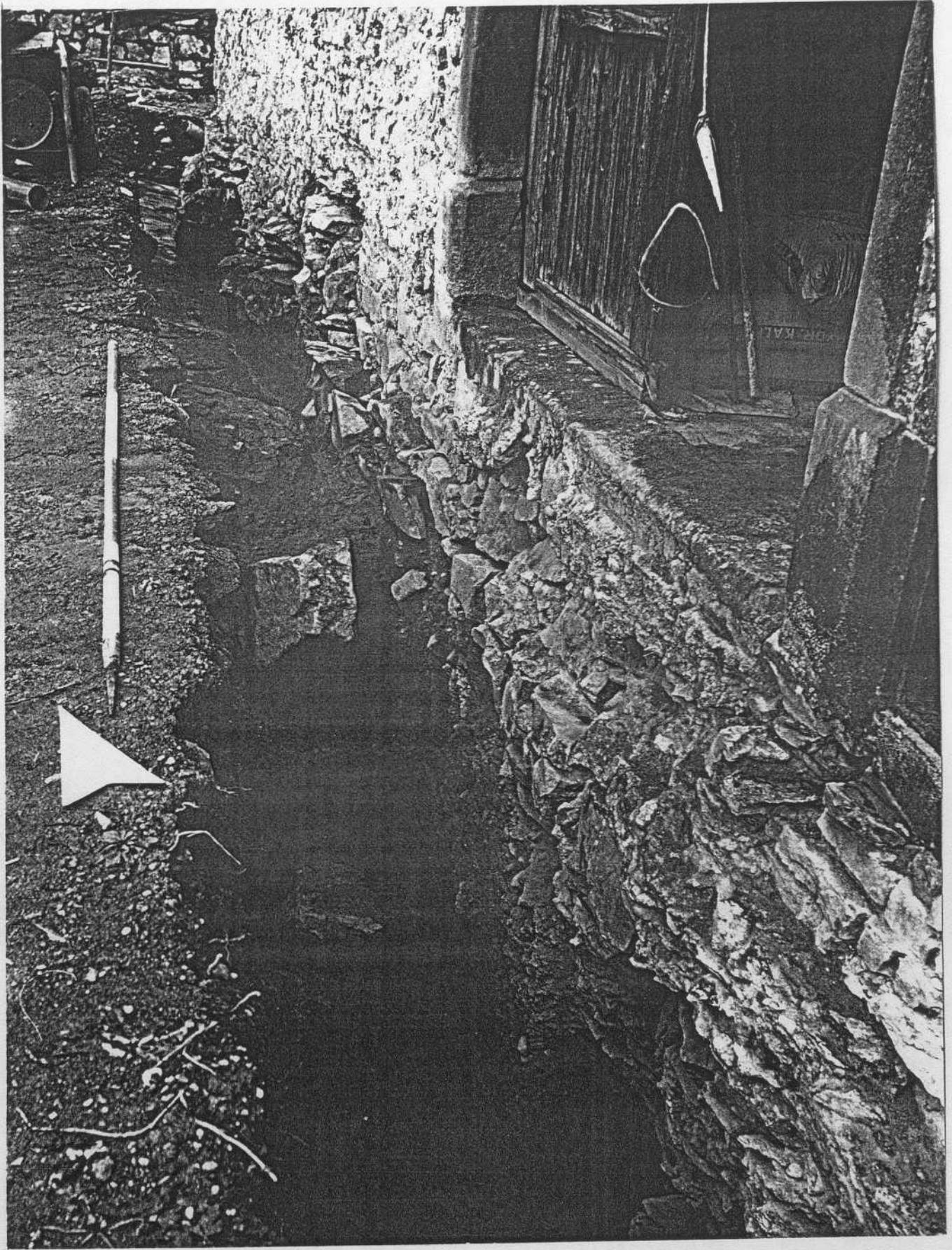
Abb. 15 Blick in die Fundamentlage (A SCH - N-W 1) der Nordwestfassade gegen die Nordecke des Hauses. Ungepflegte Fundation auf anstehendem Fels.
