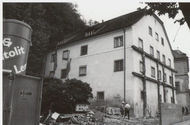
Abb. 13: Bauschäden am Liechtensteinischen Lan- desmuseum. Notsiche- rungsmassnahmen verhin- dern im Sommer 1992 den Einsturz des Gebäudes.
