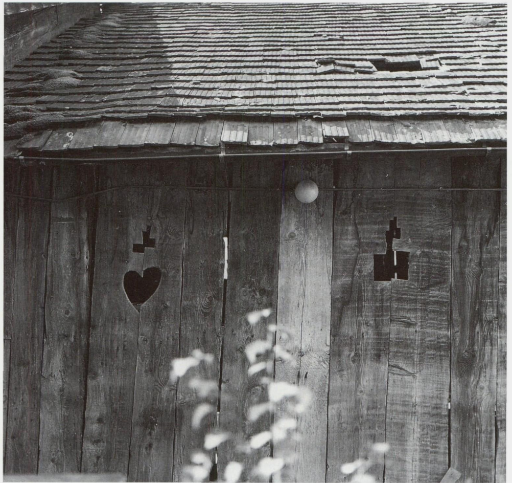
Abb. 42: Stallscheune 46; Nordfassade, Brettschirm mit älterer Dachschräge von 1715 zu Schindeldach, 1862 erhöht für Ziegeleindeckung; links Schweinestallanbau Anfang 20. Jahrhundert
