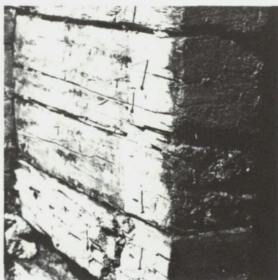
Abb. 16: Grosse Kammer, östliche Tür sekundär durchgebrochen, Detail: die Bohle in Bildmitte ist erst mit drei Bohrlöchern durchstossen, dann mit dem Stechbeitel durchtrennt worden. So wurde das Einführen einer Stichsäge ermöglicht.
