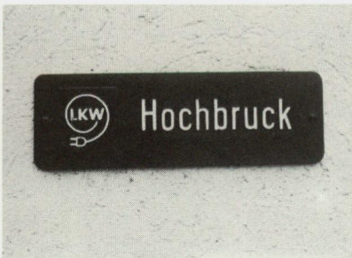
Abb. 100: Schild an einer Trafostation als Relikt eines Flurnamens
